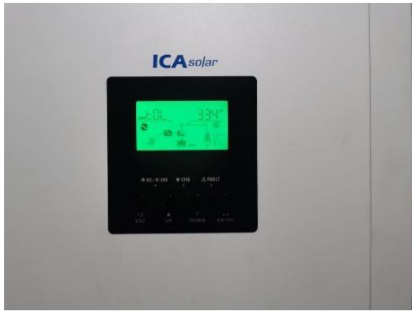
Gambar 9. Energi yang dihasilkan panel surya
