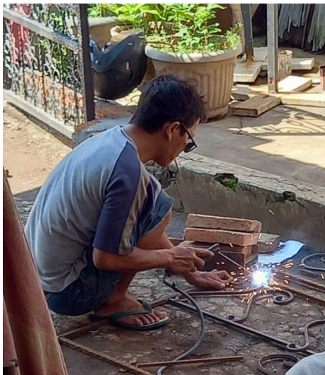
Gambar 2. Pekerja pengelasan tidak menggunakan APD.
