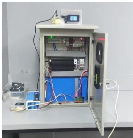
Gambar 14. Kotak Rangkaian Elektrik Panel Surya
