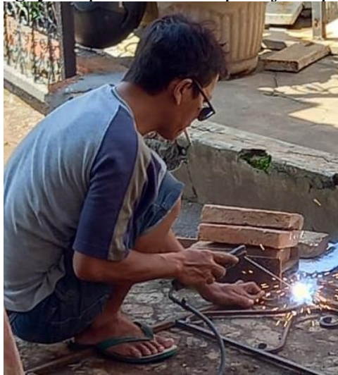
Gambar 1. Pekerja melakukan pengelasan untuk konstruksi pagar, tanpa menggunakan APD
