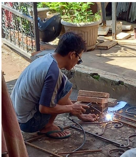
Gambar 2. Pekerja pengelasan tidak menggunakan APD.
