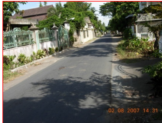
Gambar 12. Ruas jalan utama yang belum dilengkapi drainase
