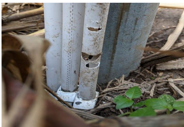
Gambar 16: Bukti pengrusakan oleh hewan pengerat
