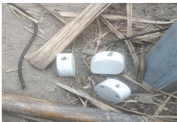
Gambar 12 : Kerusakan pada sensor
