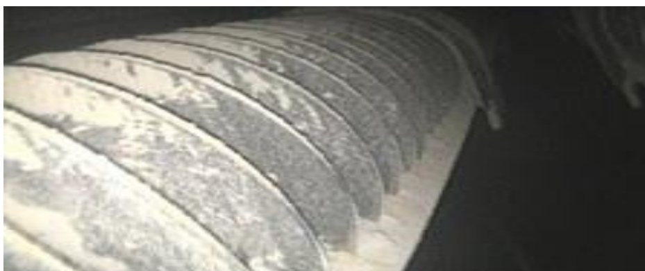
Gambar 5. Ash Deposit pada Economizer Tube Boiler .
