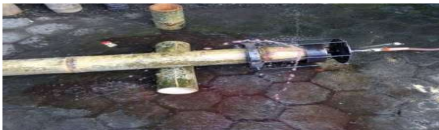
Gambar 7. Dinding Bambu Pecah Akibat Tekanan.
