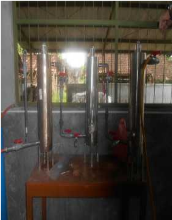
Gambar 1. Instalasi Pemurnian Biogas Skala Pilot Plant.
