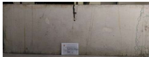
Gambar 6 Pola kerusakan benda uji tekan PP-T1
