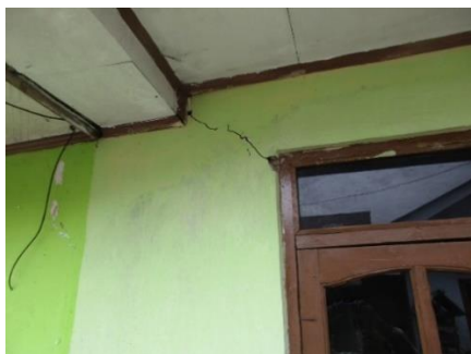
(a) Rusak Ringan
