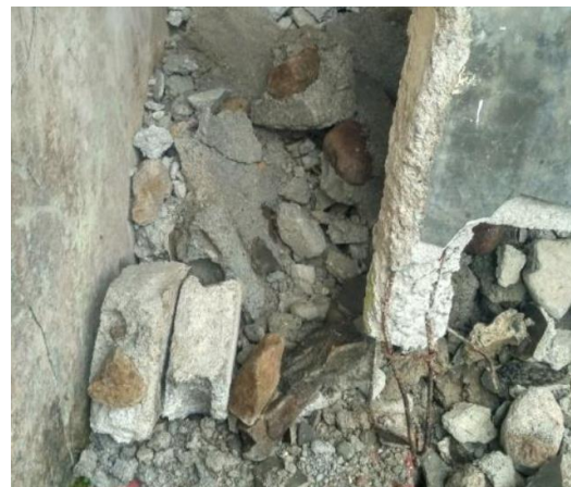
Gambar 3. Kegagalan sambungan ( joint ) (Saputra & Faizah, 2019)
