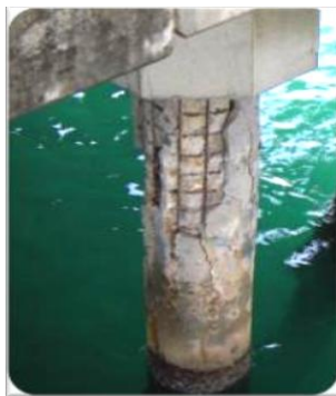
Gambar 1. Kerusakan beton pada struktur di lingkungan agresif
