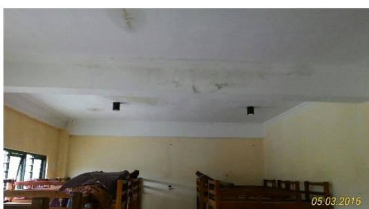
Gambar 3. Rembesan air di tengah pelat lantai
